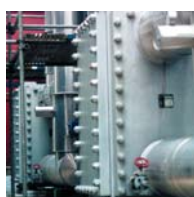
Компаблок в системе утилизации тепла жидкость-жидкость
