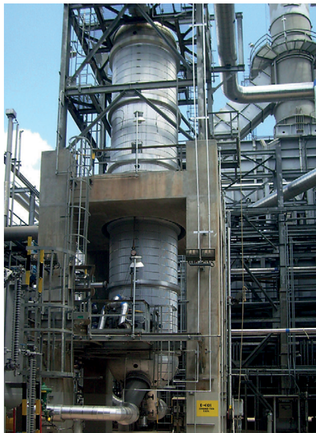
Теплообменник Packinox на установке каталитического риформинга.
